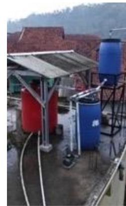
Gambar 11 Water treatment system yang Telah Terpasang
